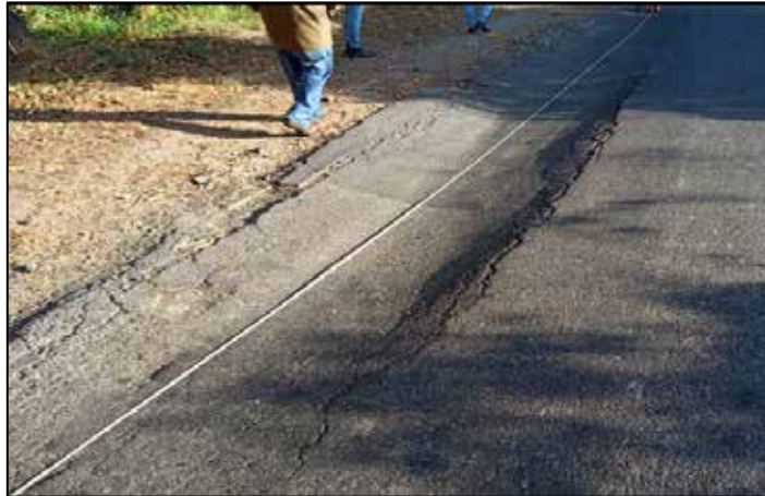
Figura 67: Hundimiento en la calle Cumaca.
