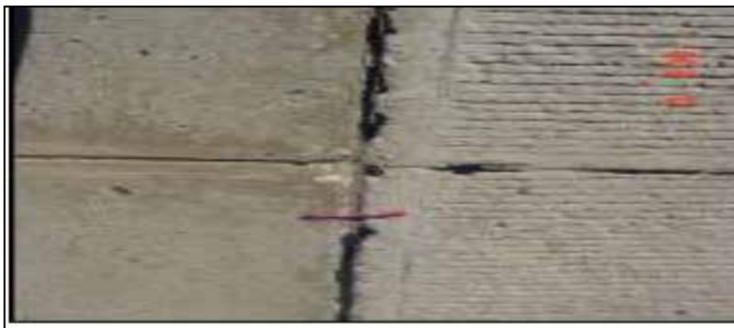
Figura 13. Fallas de juntas del pavimento rígido
