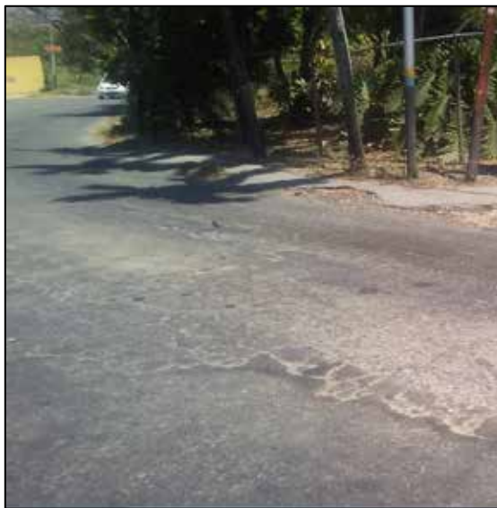
Figura 66: Fisura Longitudinal en la calle Cumaca.
