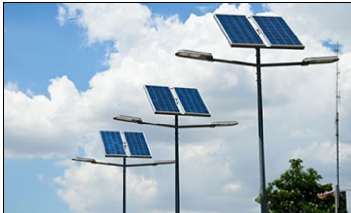
Figura 81: Poste de Alumbrado Público Fotovoltaicos
