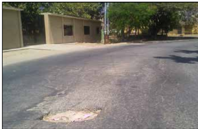
Figura 68: Bache en la calle Cumaca.
