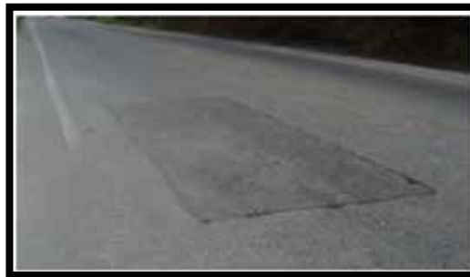
Figura 10. Daños superficiales del pavimento flexible
