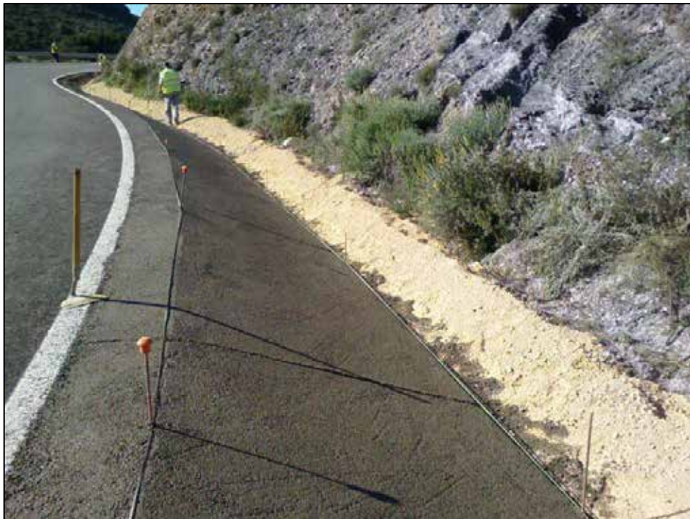
Figura 23: Drenaje Longitudinal de Vía
