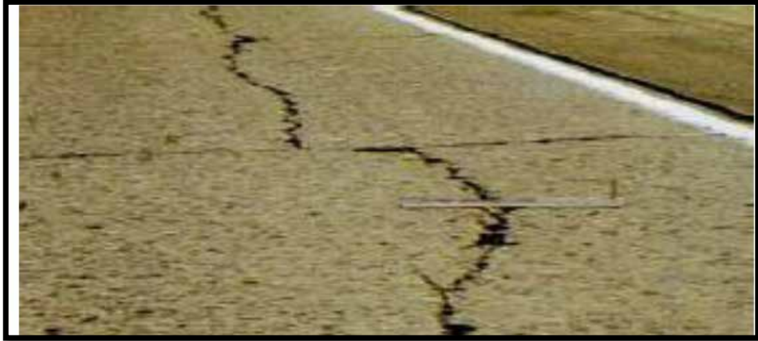
Figura 14. Fisura y Grietas del pavimento rígido
