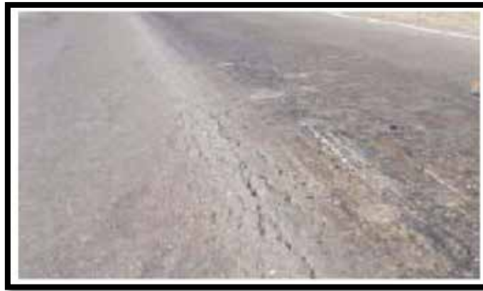
Figura 11. Deformaciones del pavimento flexible
