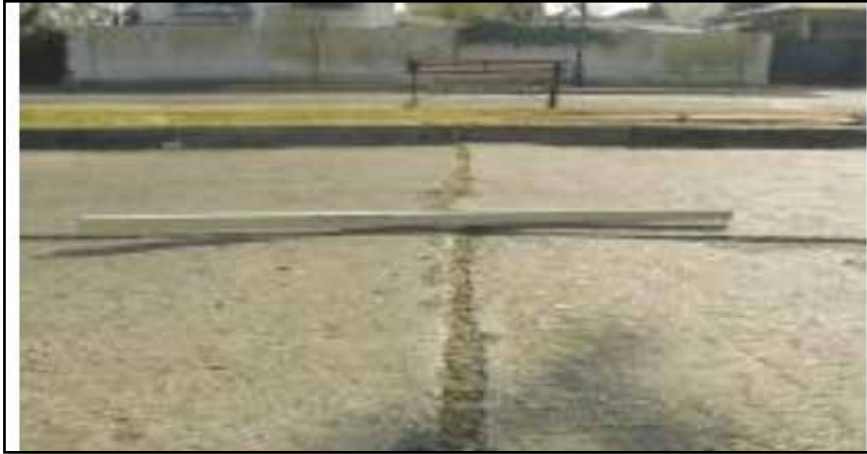
Figura 16. Otros deterioro del pavimento rígido
