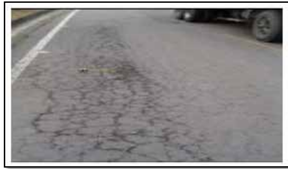
Figura 9. Fisura del pavimento flexible
