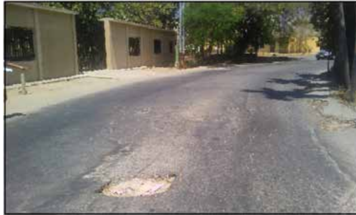
Figura 2: Falla de Pavimento de la Calle Cumaca
