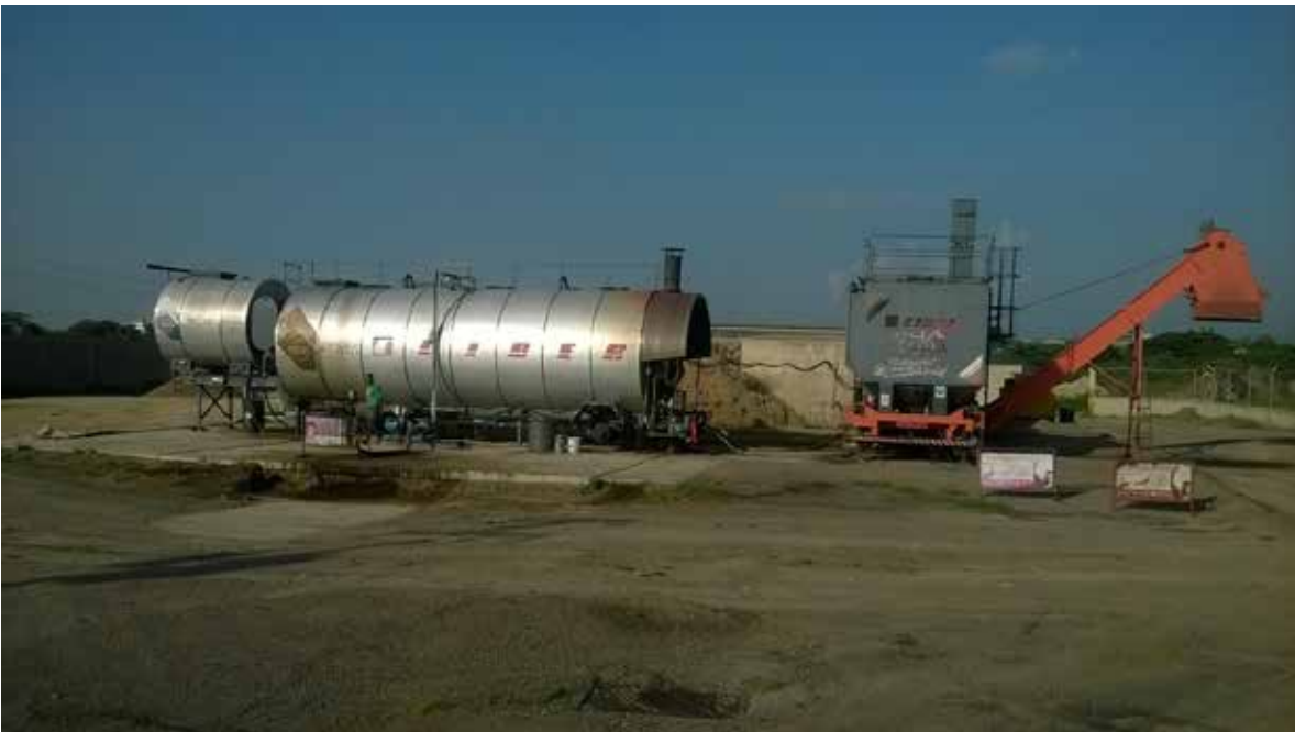
Figura N° 6: Tanque de solución asfáltica (RC2) y planta CIBER NOVA de la EMAG C.A.
