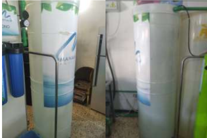
Figura 15: Tanques de almacenamiento de agua de 500 lts
