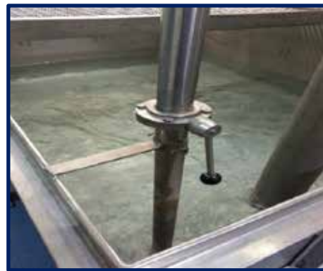
Válvula de Agua
