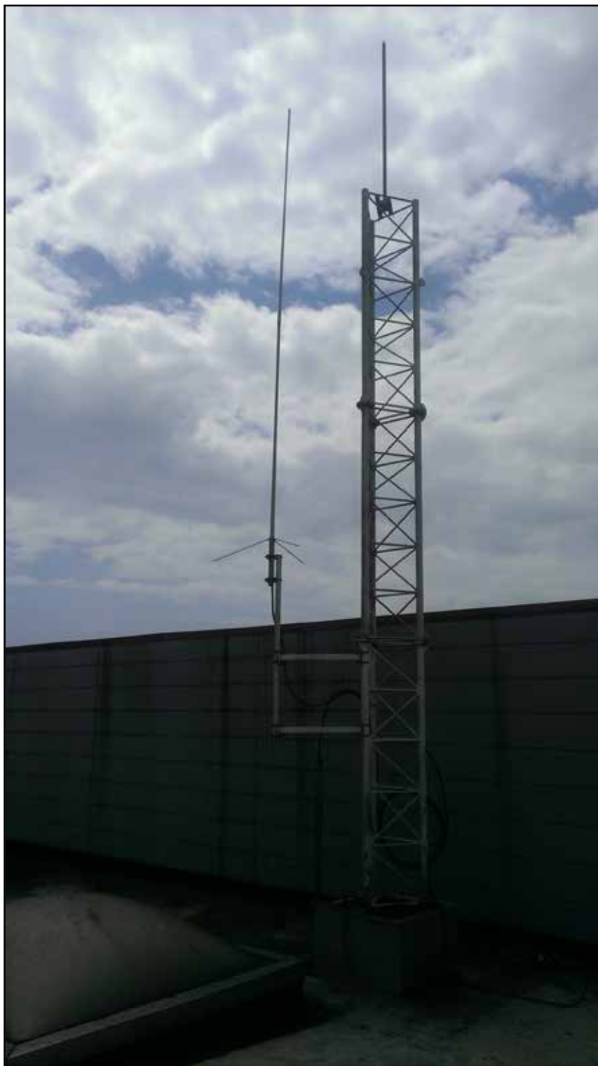
Arreglo de antenas dipolos dobles de las estaciones bases 3 existente.
