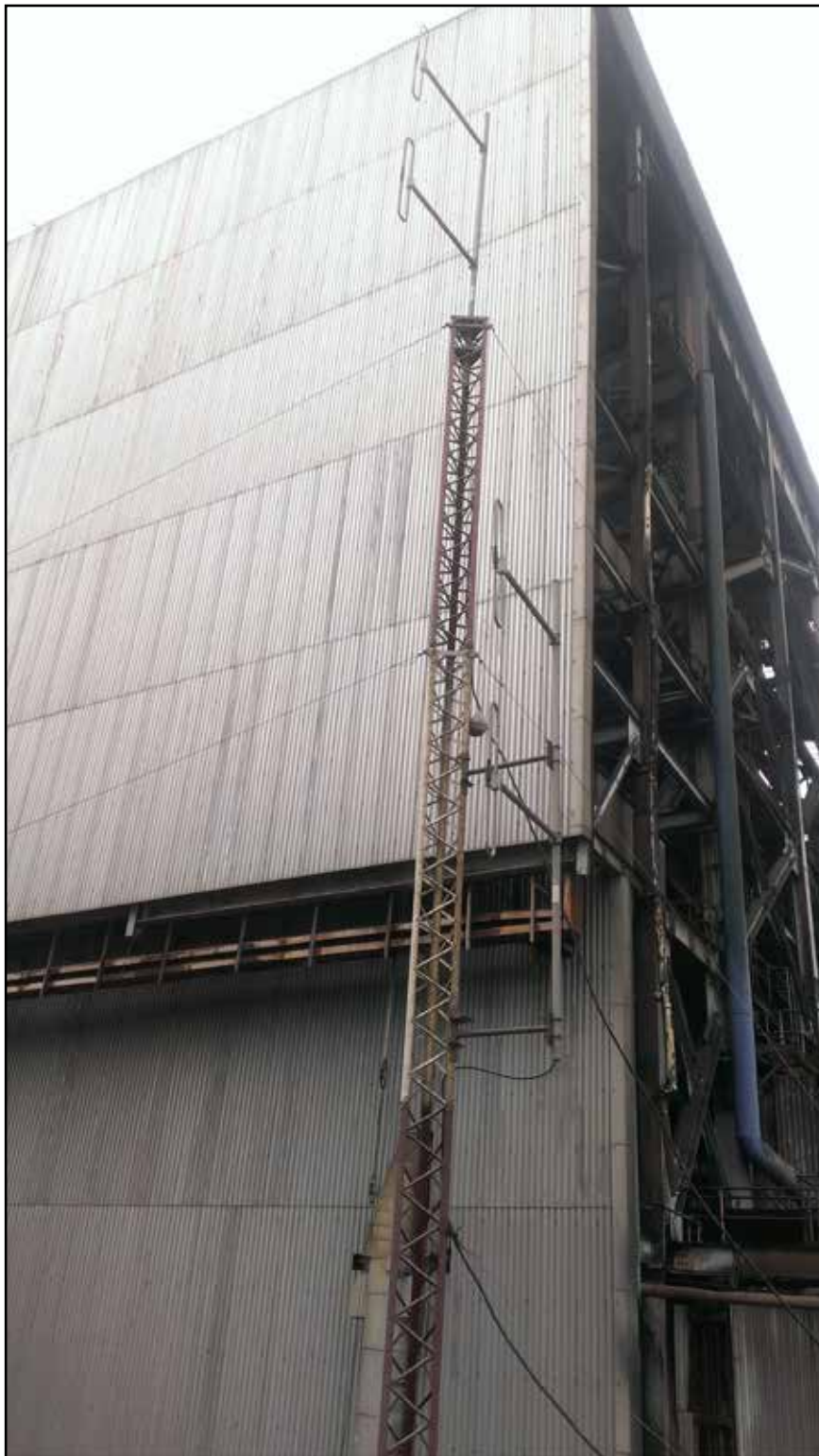
Arreglo de antenas dipolos dobles de las estaciones bases 2 existente.
