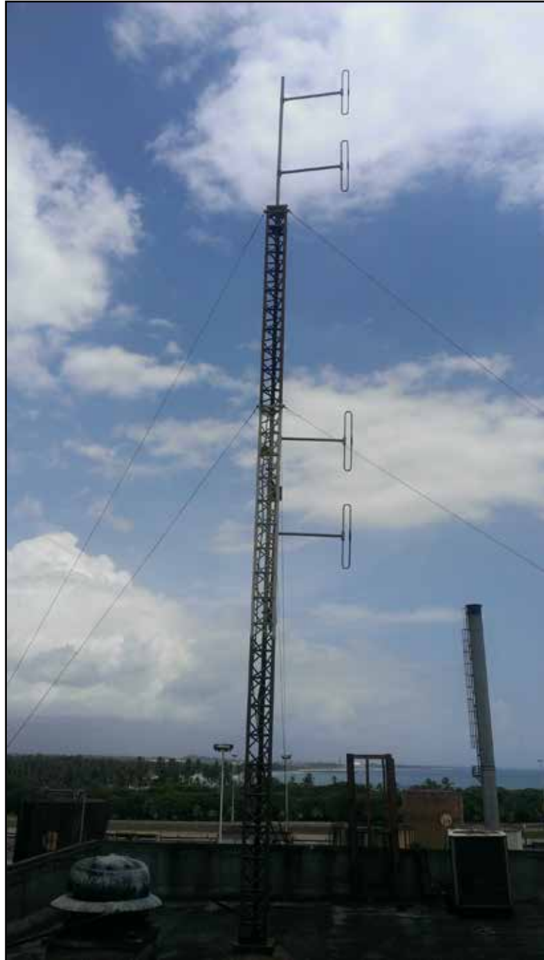
Arreglo de antenas dipolos dobles de las estaciones bases 1 existente.
