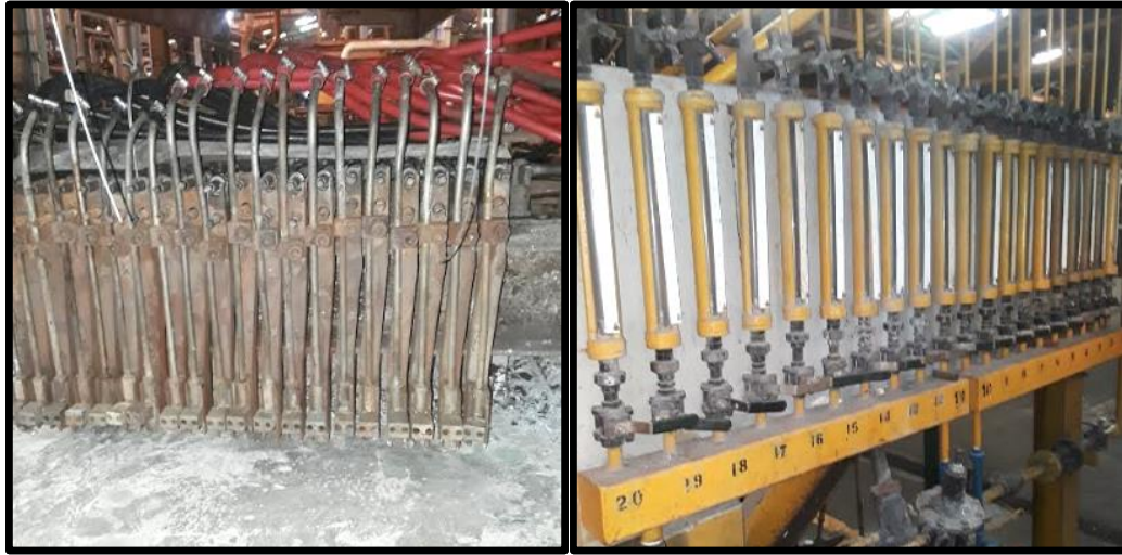
Figura 6. Sistema Jet Wipe de la línea de galvanizado dos en la empresa Vicson, S. A. Fuente: Departamento de Producción Vicson, S. A. (2018)
