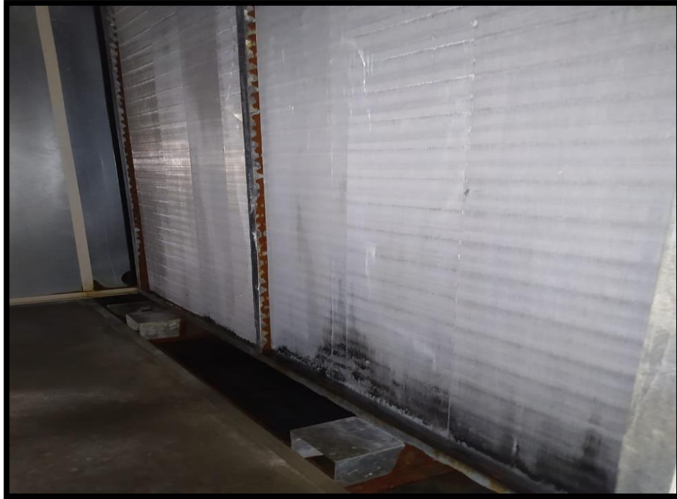
Figura 12. Serpentín de agua caliente de las UMA del sistema HVAC Fuente: Barrios y Bolívar (2023)
