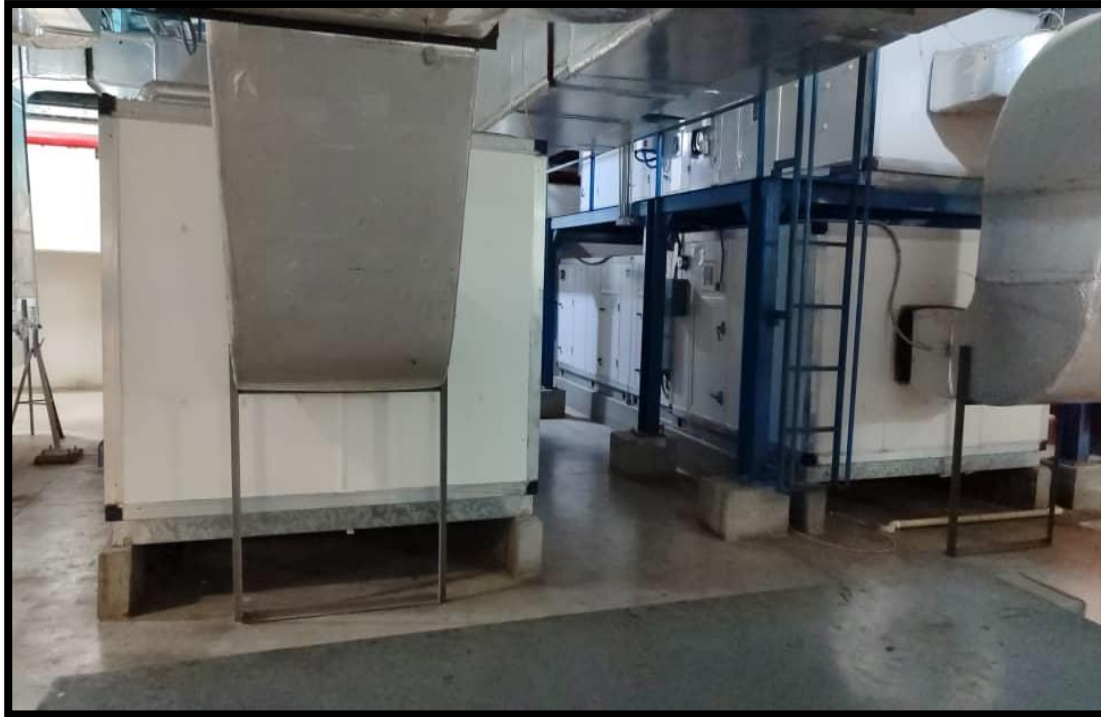
Figura 10. UMAs del sistema HVAC del área de producción sólidos Fuente: Barrios y Bolívar (2023)
