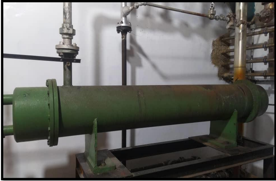
Figura 13. Intercambiador de calor de coraza y tubos Fuente: Barrios y Bolívar (2023)
