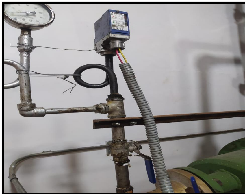
Figura 18. Presostato a la salida del intercambiador Fuente: Barrios y Bolívar (2023)
