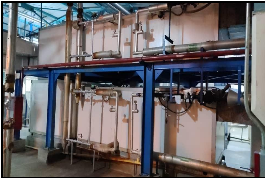
Figura 11. Tuberías de entrada y salida de agua caliente de las UMA del sistema HVAC Fuente: Barrios y Bolívar (2023)
