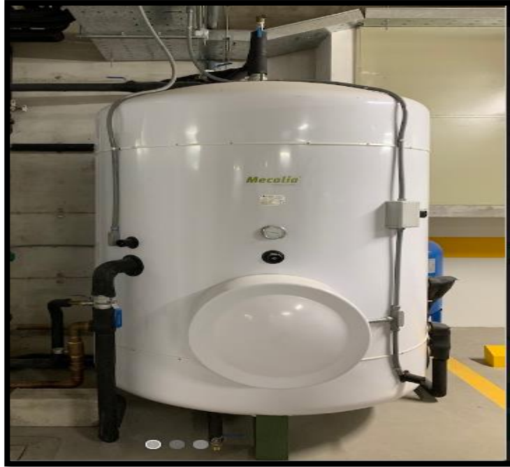
Figura 26. Tanque de acumulación de agua caliente Fuente: Aguacobre (2023)
