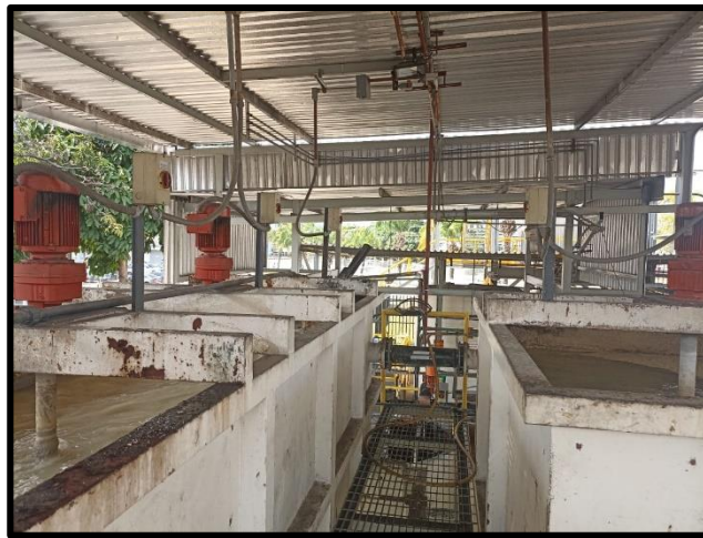
Figura 17. Tanque de Mezcla Rápida y Tanque de Mezcla Lenta.
