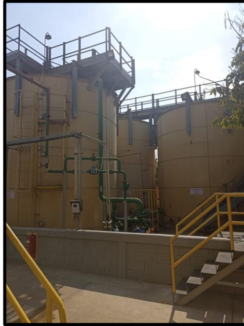
Figura 16. Tanques Homogenizadores de planta de tratamiento
