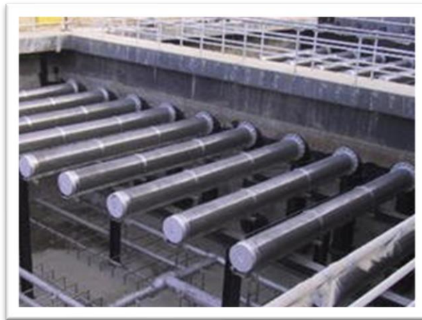
Figura 30. Filtro horizontal cilíndrico para MBBR aerobio.
