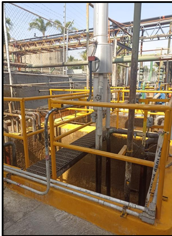
Figura 14. Tanquilla Principal de planta de tratamiento
