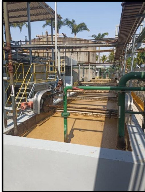
Figura 15. Raspanatas de planta de tratamiento
