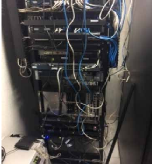
Figura 12. “Equipos de transmisión de datos ubicados en el rack”
