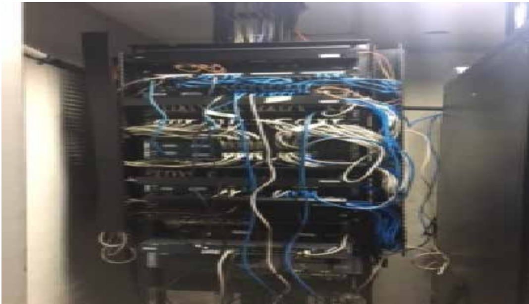
Figura 10. “Rack de comunicaciones”
