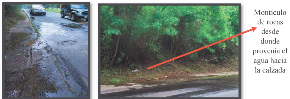
Figura. -34: Esgurrimiento de agua desde el macizo rocoso después de días de lluvias
