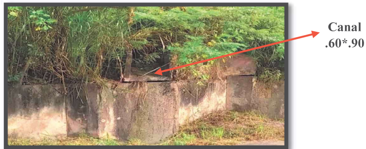
Figura. -32: Único canal para A. Pluviales deteriorado en el tramo de estudio. Fuente: Rojas L. (2022)
