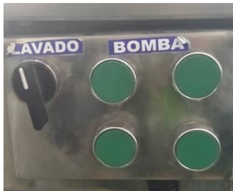
Figura 9: Botones para el control de la salida del agua en el sistema de llenado en conjunto al interruptor del lavado
