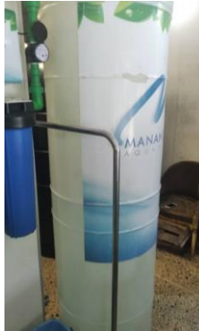
Figura 7: Tanque de almacenamiento de líquidos de 500 lts.
