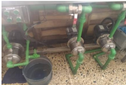
Figura 8: Bombas y tuberías que conectan los tanques de almacenamiento junto a la válvula manual reguladora de caudal de agua.
