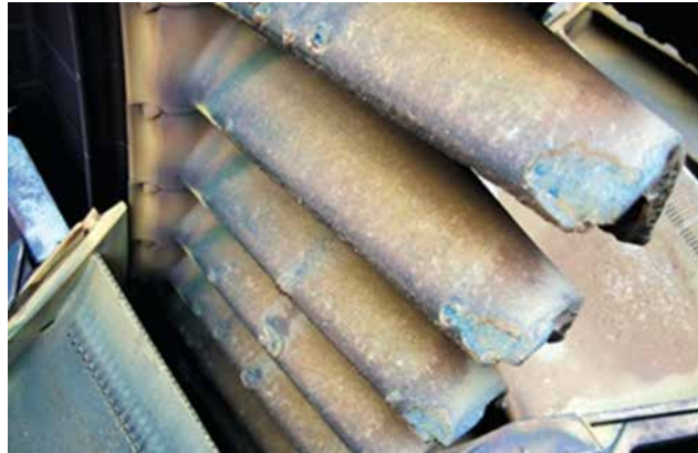
Figura 27. Corrosión en turbina de gas.
