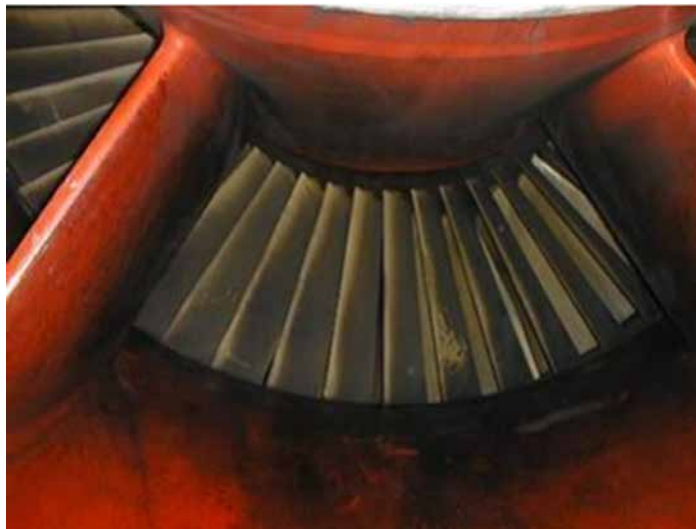
Figura 30. Ensuciamiento en compresor de turbina de gas. Fuente: Turbotec
