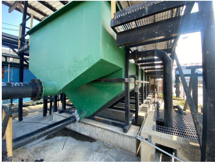
Anexo 01: Tanque DAF de PTAR.
