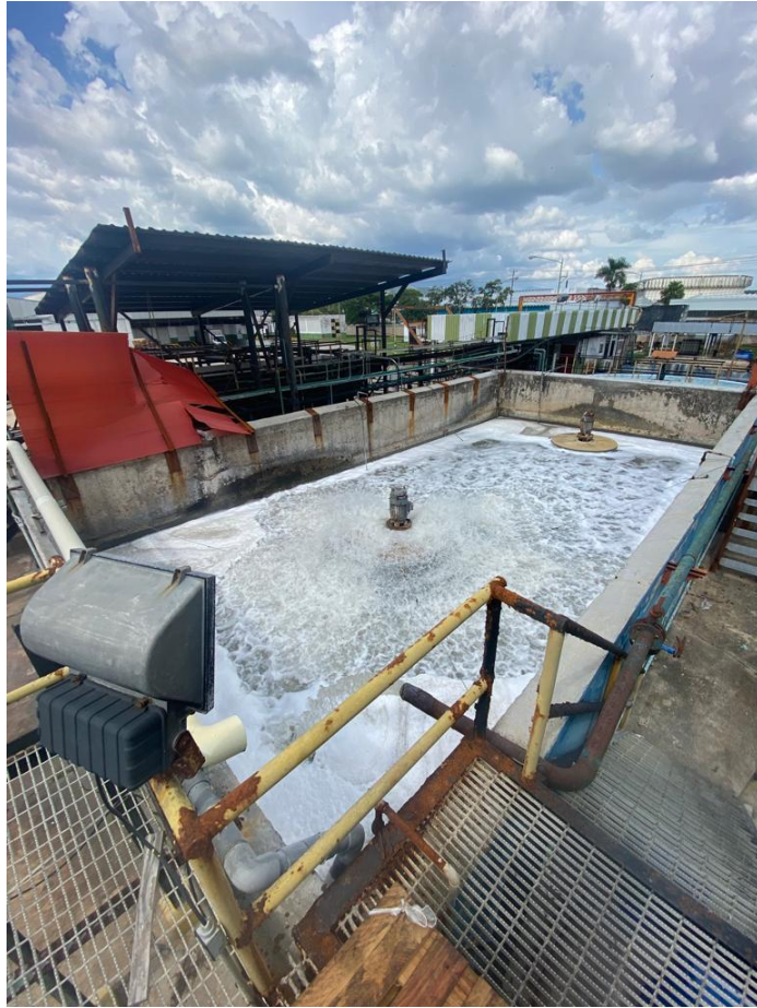
Anexo 03: Reactor Biológico de PTAR
