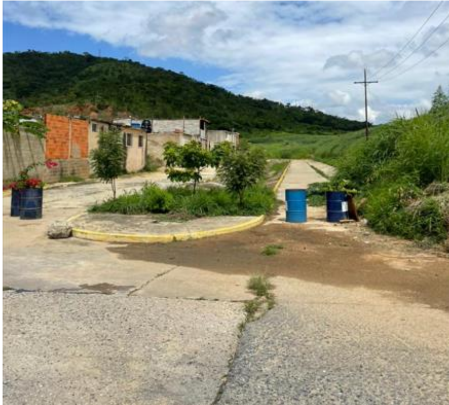
Figura 4. Condiciones actuales de la vialidad adyacente al canal
