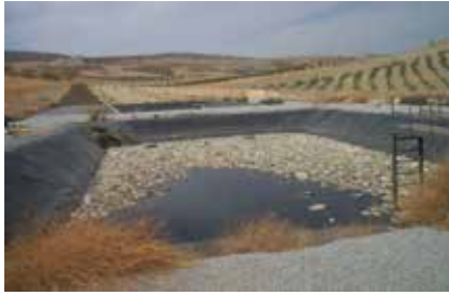
Figura 2. Laguna de recepción de lixiviados. Fontanet y Poveda. (1999).
