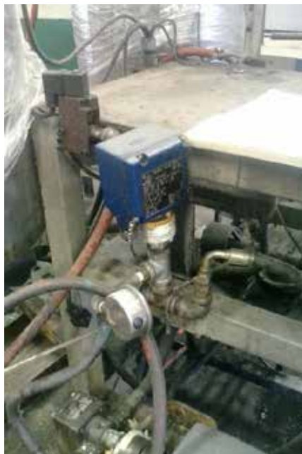
Anexo A: Figura 4. Presostano de la línea de alimentación de Polioli e Isocianato
