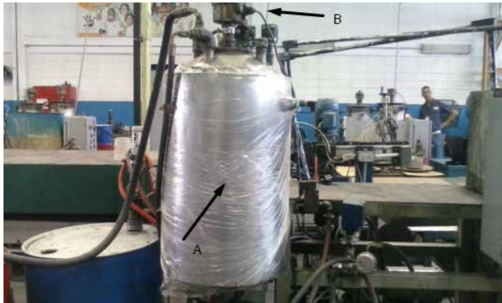
Anexo A: Figura 3. Tanque de mezcla de Polioli e Isocianato (A) y Mezclador interno (B)
