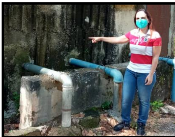
Figura 18. Tuberías que surten al tanque de abastecimiento de la comunidad de Carialinda.
