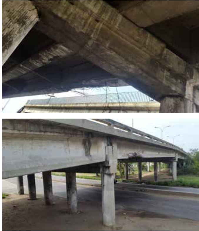
Figura 23: Agrietamiento de las vigas del puente Fuente: De Caires, Y. (2017)
