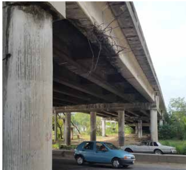
Figura 13: Desgaste de la viga principal por golpe del flujo vehicular pesado.
