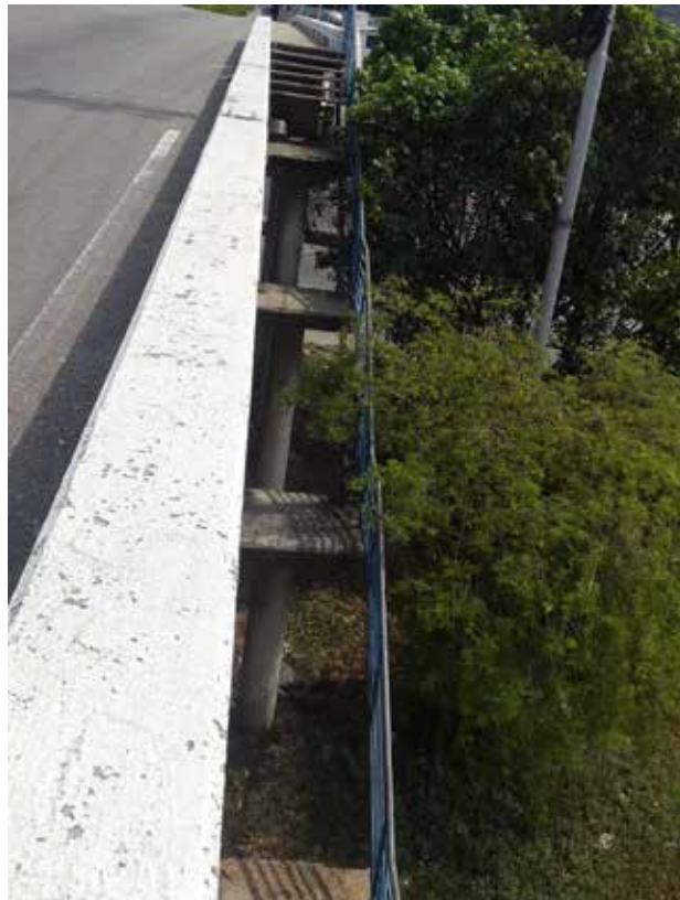
Figura 15: Ausencia de escalones para acceso peatonal al puente.
