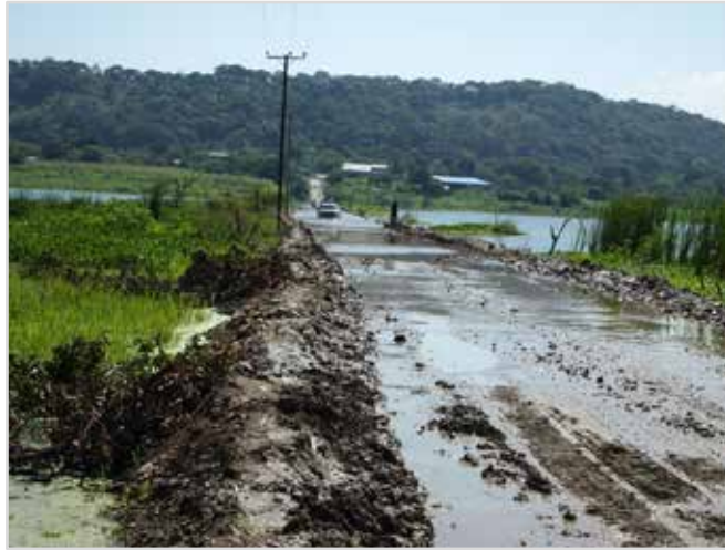
Figura 16. Estado de la Vialidad Principal de La Isla La Culebra. (2016)
