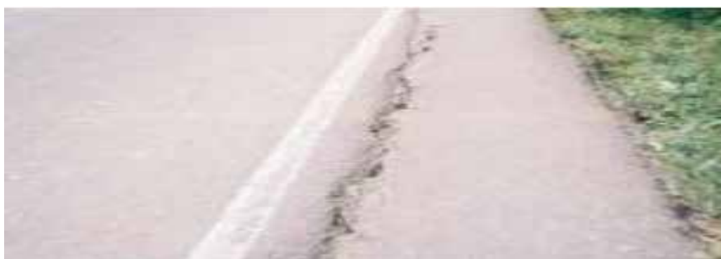
Figura 20: Separación Entre Berma y Pavimento
