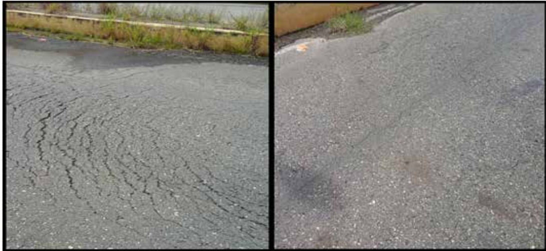
Figura 23: Fallas de fisuras transversales y longitudinales Av. Che Guevara
