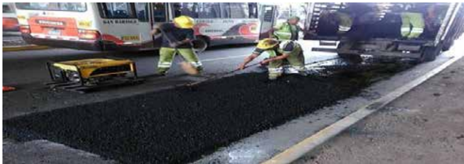
Figura 33: Parchado Superficial. Fuente: Trabajo de Grado “Análisis Superficial De Pavimentos Flexibles Para El Mantenimiento De Vías En La Región De Puno” Katia Humpiri Pineda Perú 2015.
