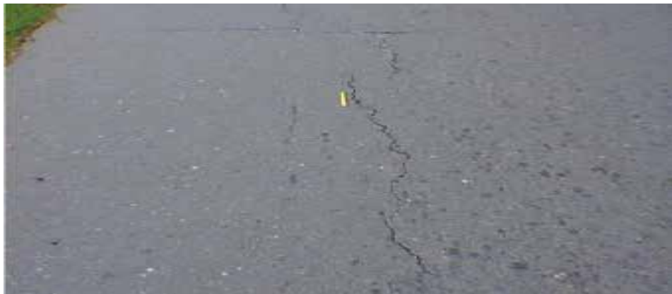
Figura 9: Fisuras y Grietas Transversales y Longitudinales
