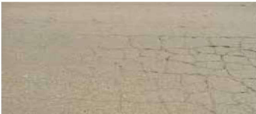
Figura 7: Fisuras y Grietas en Bloques
