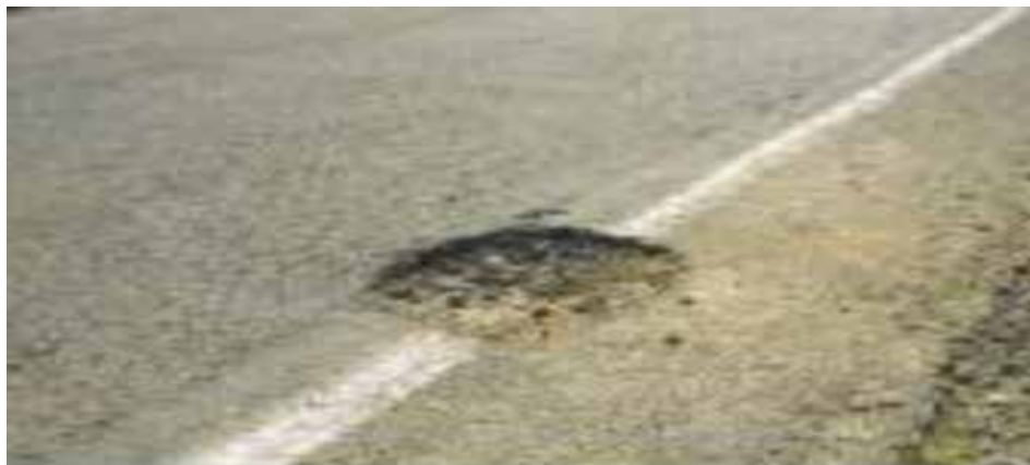
Figura 12: Baches en Carpetas Asfálticas y Tratamientos Superficiales
