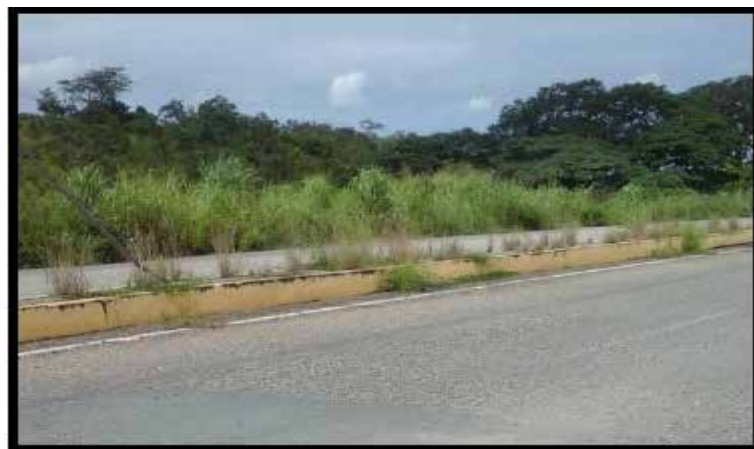
Figura 29: Daños por vegetación Av. Che Guevara
