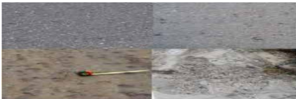
Figura 16: Perdida de Áridos
