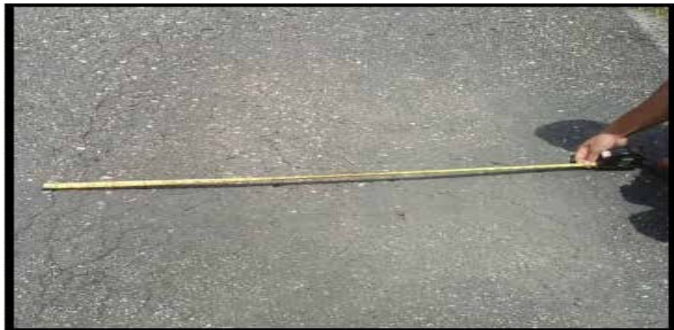
Figura 26: Falla por ahuellamiento Av. Che Guevara
