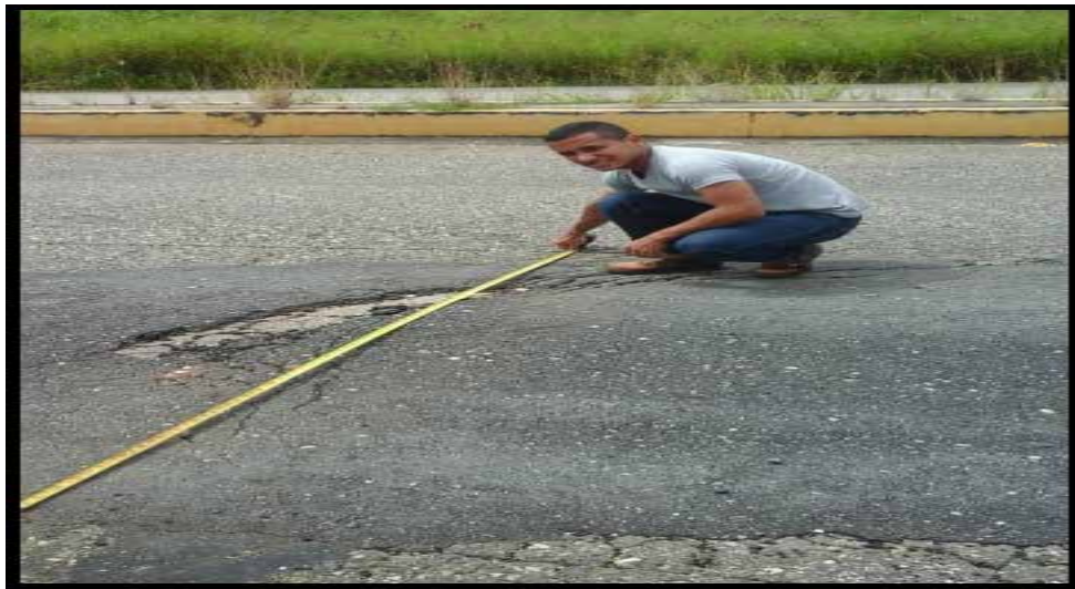
Figura 25: Parches deteriorado Av. Che Guevara
