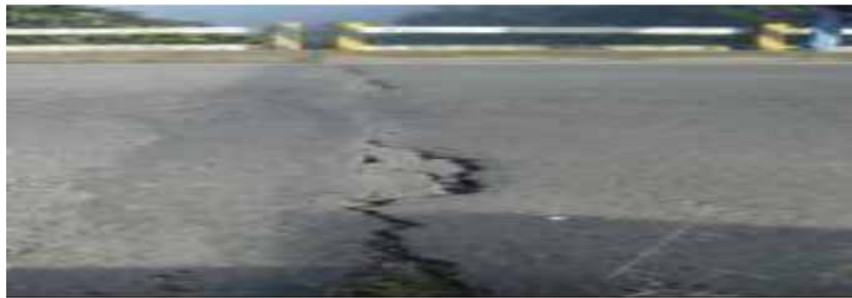
Figura 10: Fisuras y Grietas Reflejadas
