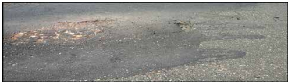
Figura 24: Parches deteriorado Av. Che Guevara
