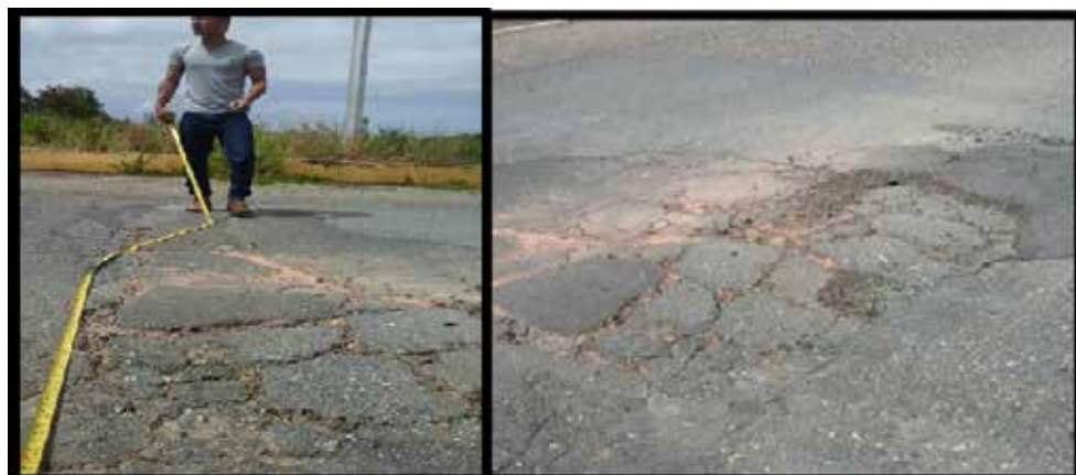
Figura 28: Daños Estructurales Av. Che Guevara
