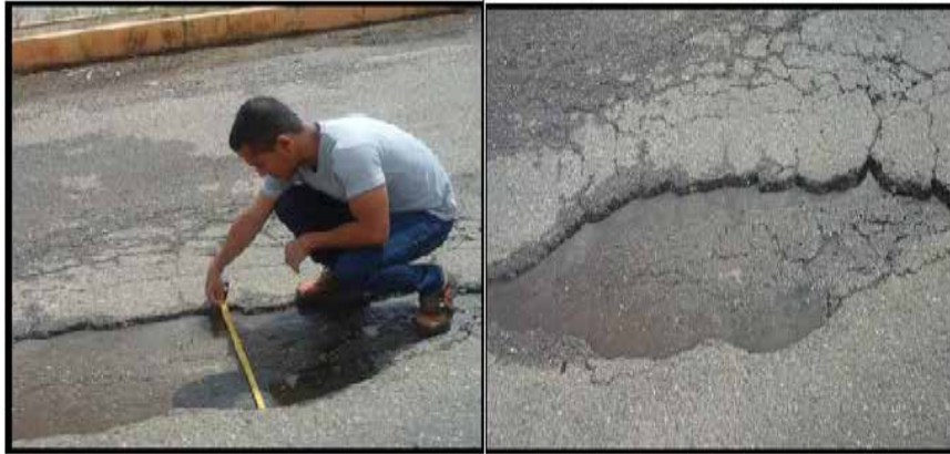
Figura 27: Daños en carpeta asfáltica Av. Che Guevara
