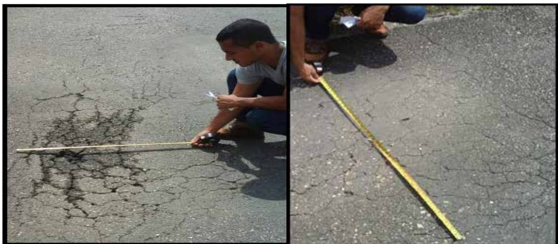
Figura 22: Fallas de fisuras por Fatigamiento Av. Che Guevara
