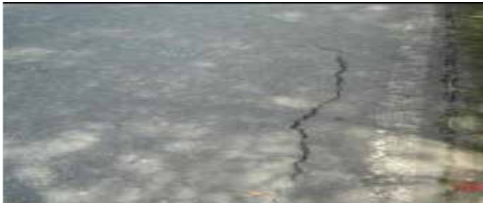
Figura 8: Grietas de Borde
