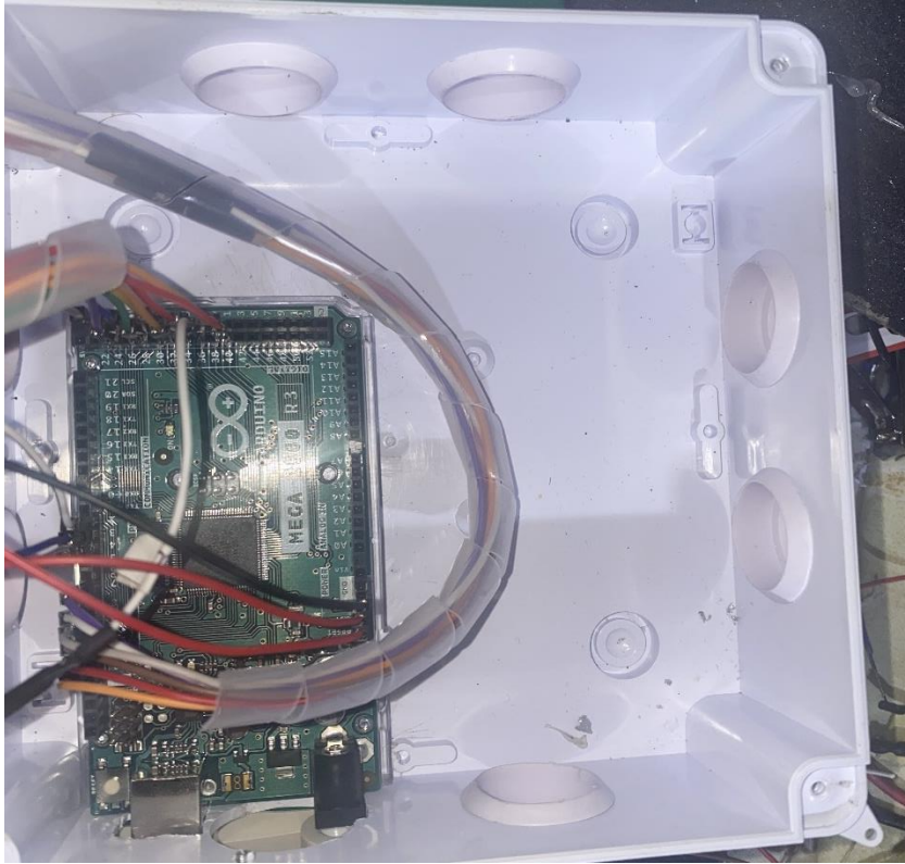
Figura 30. Prototipo del sistema de monitorización (Parte interna inferior de la caja)
