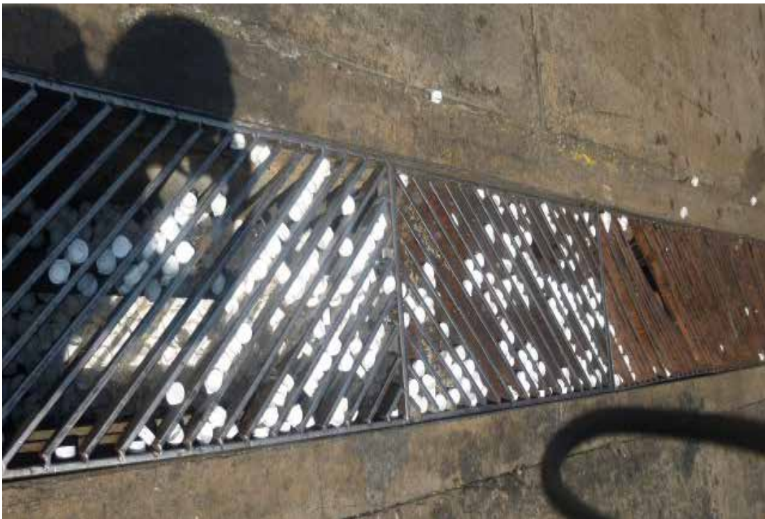
Figura 11 Tapas de polietileno (Contaminadas)
