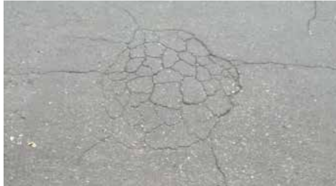
Figura 35: Piel de cocodrilo en la calle Valencia.
