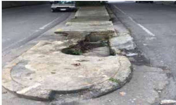
Figura 40: Falla en sumidero de ventana.
