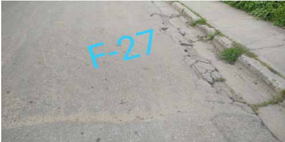
Figura 33: Falla de borde en la calle Rondón.
