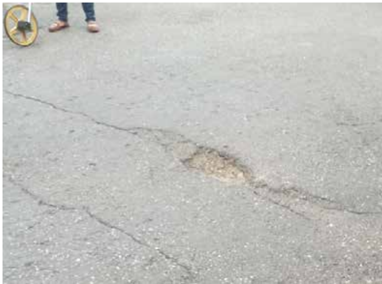
Figura 34: Fisura longitudinal en la calle Sucre.
