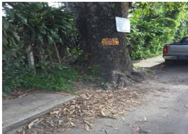
Figura 38: Obstrucción de acera en la calle Rondón.
