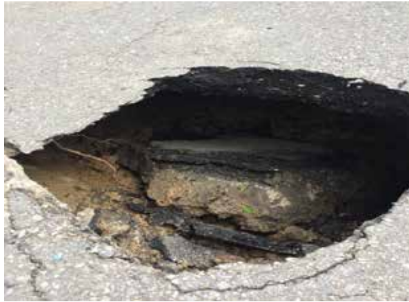
Figura 37: Daño en capa estructural en la Calle Tejerías.
