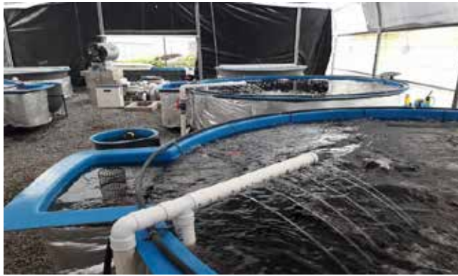
Figura 2. Proyecto aQüidar área de peceras y sistemas de recirculación de agua.
