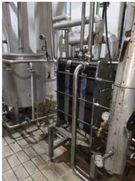
Figura 20. Intercambiador de calor Fuente: Quintana, A. y Díaz, M. (2021)
