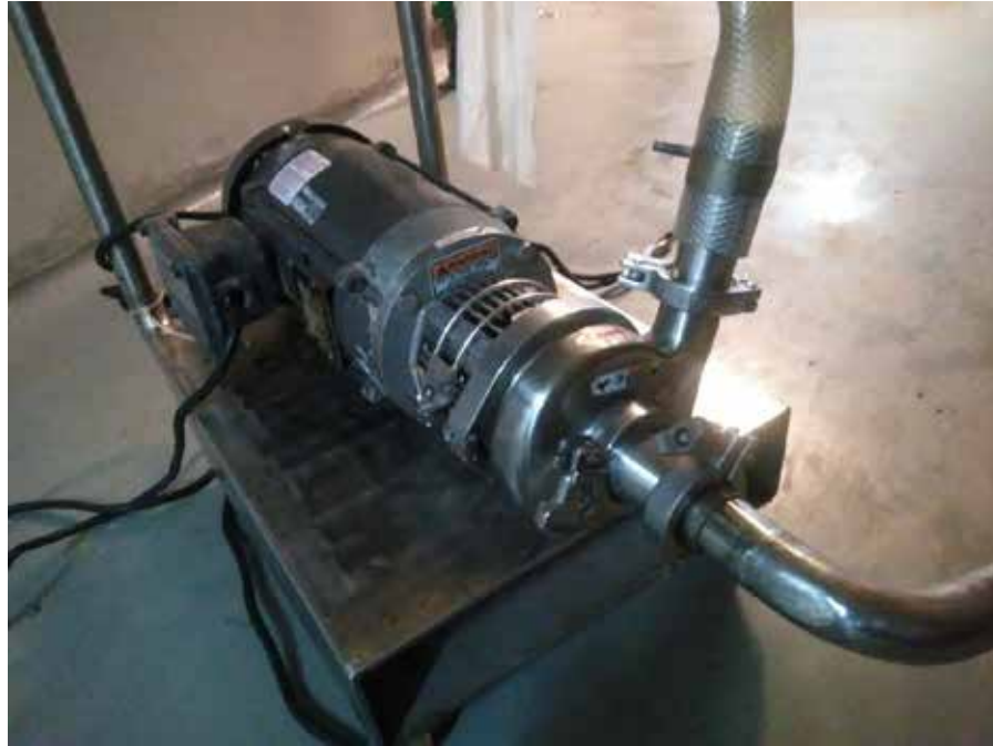
Figura 6 Bomba centrífuga de 1.5 hp marca Waukeska
