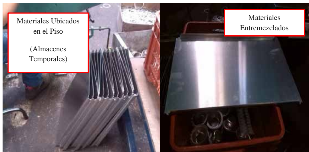
Figura 9. Materiales entremezclados y ubicados en el piso.
