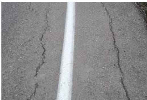
Figura 4. Grieta de borde
