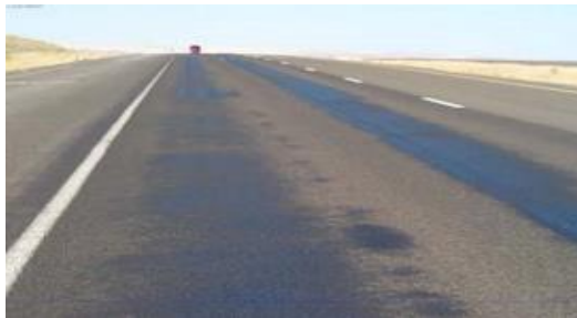
Figura 5. Exudación de asfalto
