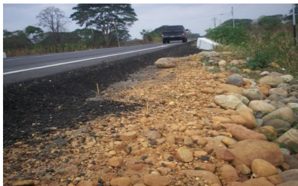
Figura 7. Desnivel calzada hombrillo
