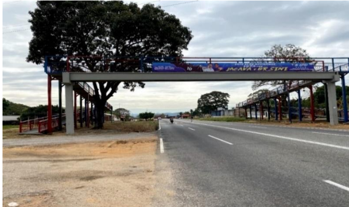
Figura 20. "Puente peatonal metálico de la carretera vía Bejuma Sector Lagunita Fuente: Colmenares y Rendón (2022)
