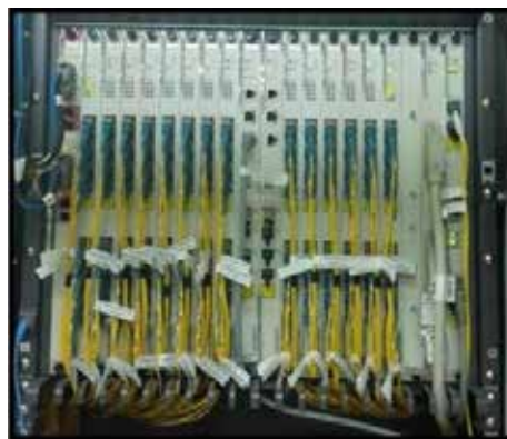
Figura 6. OLT Huawei 5600T 14 tarjetas con 8 puertos PON.
