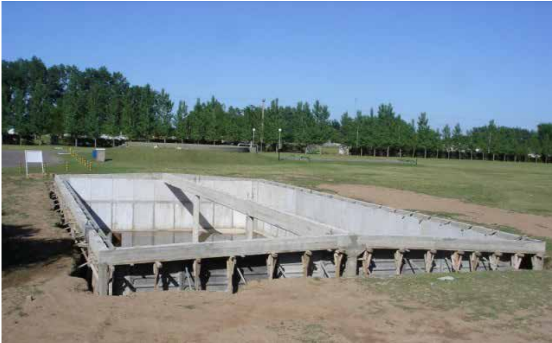
Figura 10. Tanque industrial con capacidad de 1.000.000 de litros.
