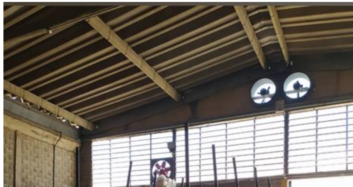
Figura 2: Sistema de ventilación y extracción de calor
