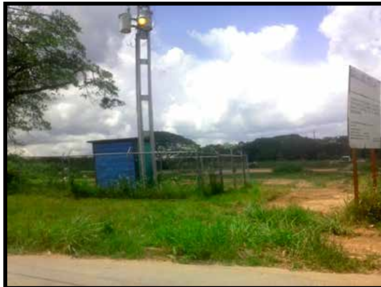
Casa del equipo de bombeo actual del sector el Cementerio.
