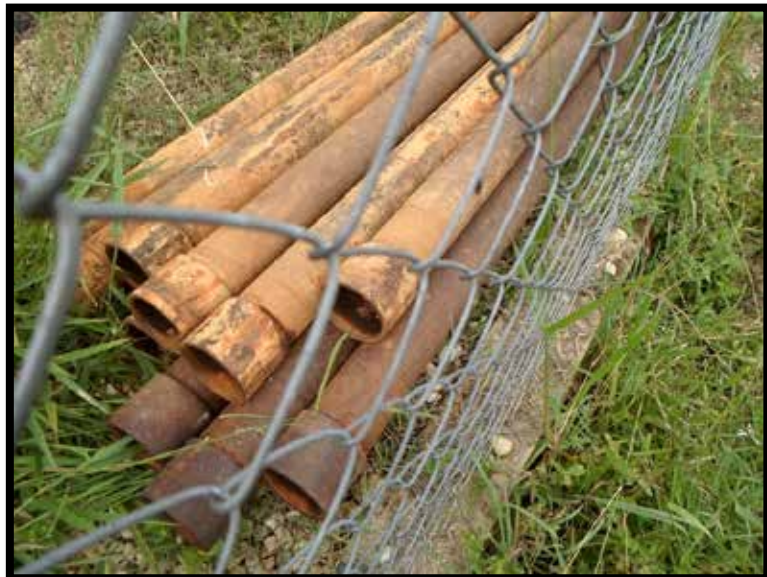
Tuberías subterráneas del pozo en el sector el Cementerio.
