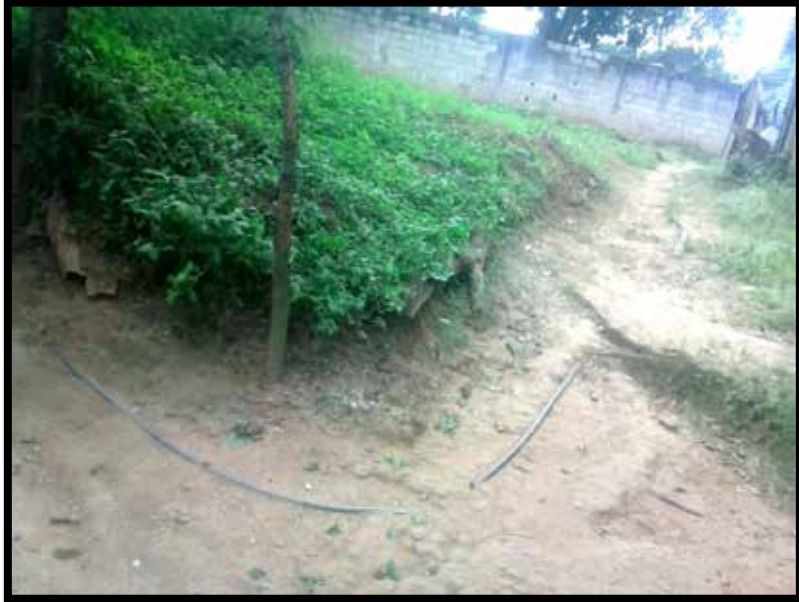
Tubería de dos pulgadas (2") ubicada en el sector el Cementerio.
