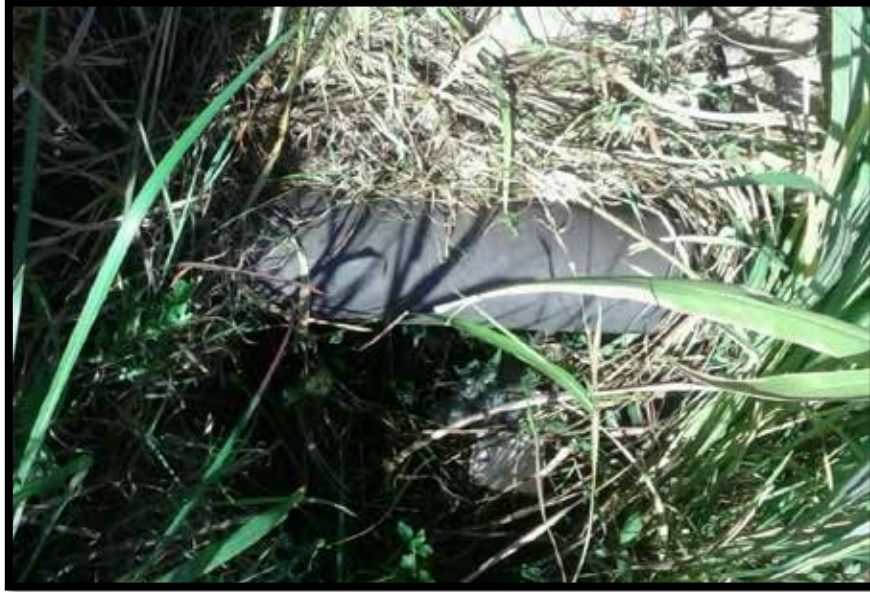
Tubería de seis pulgadas (6") ubicada en el sector el Cementerio.
