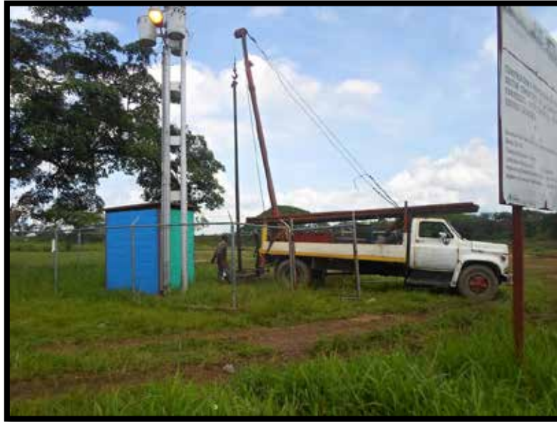
Mantenimiento de Tuberías subterráneas del pozo en el sector el Cementerio (14 julio 2017)
