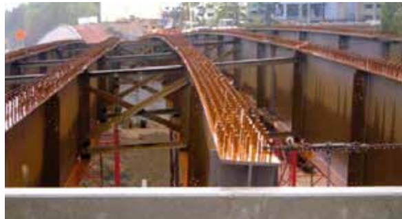
Figura 4. Desplazamiento excesivo en vigas de un puente de acero antes de la fundición de la losa.
