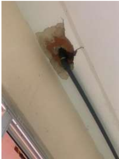
Figura 5 Perforación en Viga para instalación sanitaria
