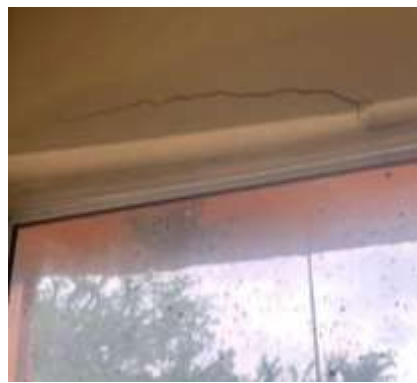
Figura 2 Deterioro en dinteles
