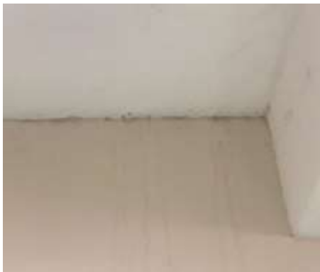
Figura 1 humedad en paredes
