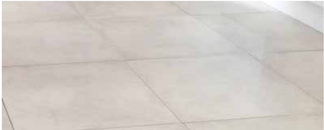
Figura 36. Acabado de piso en porcelanato beige de 30x60. Fuente http://www.sodimac.cl/sodimac-cl/category/scat991120/Porcelanatos (2018)
