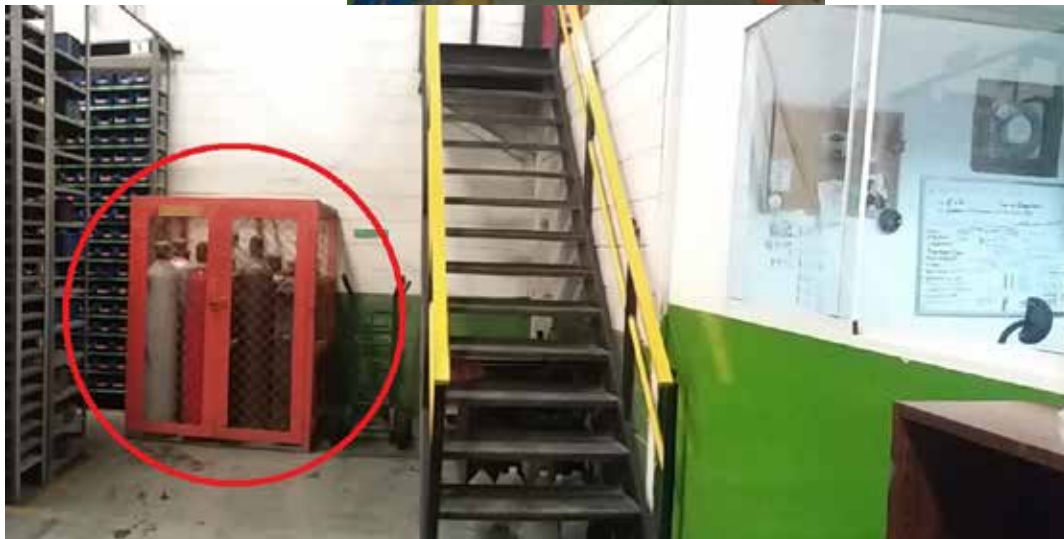
4. Ubicación incorrecta de Cilindros de Gases Inflamables
