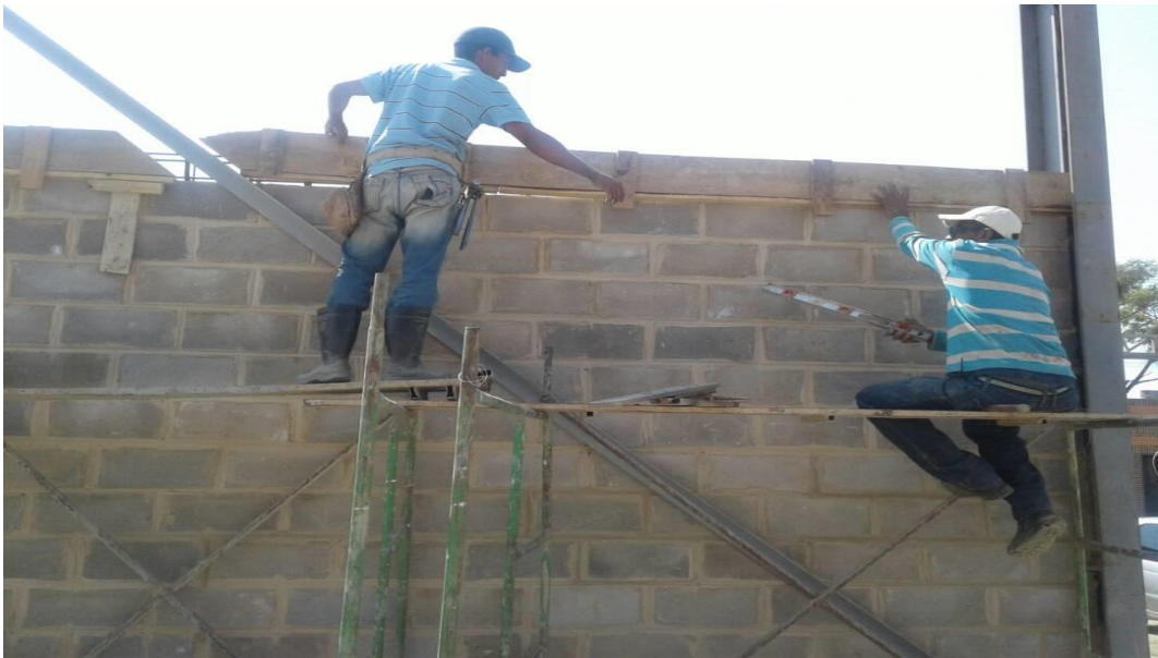
Condiciones inseguras de trabajo Fuente: Godoy, C. (2021)
