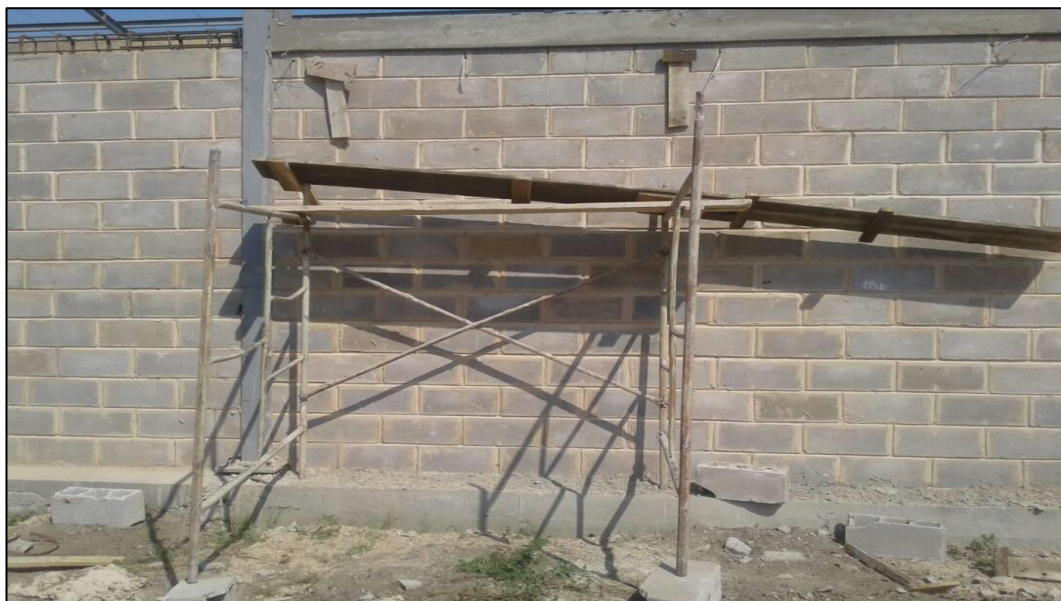
Condiciones inseguras de trabajo donde se puede evidenciar la falta de medidas preventivas Fuente: Godoy, C. (2021)
