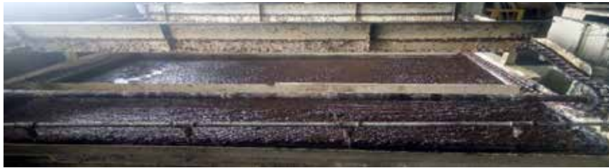
Figura 13: Barro Arrastrado Denominado Espuma en la Clarificadora de Licor.
