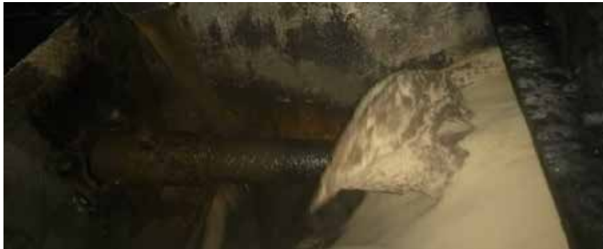
Figura 5: Tornillo Sin Fin de la Tolva de Afinación Alimentador del Sistema de Disolución.
