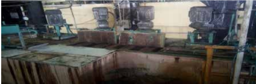
Figura 11: Tanque de Reacción o Tanque de Licor Tratado.
