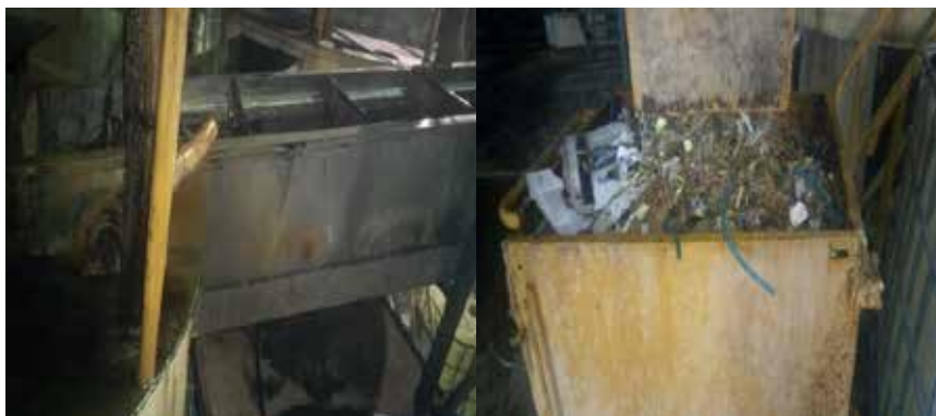
Figura 7: La Noria en la (Izq.) y el Contenedor de Solidos Arrastrados por la misma.
