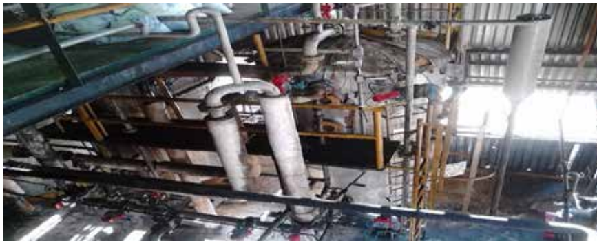
Figura 15: Filtros de Lechos Profundos.
