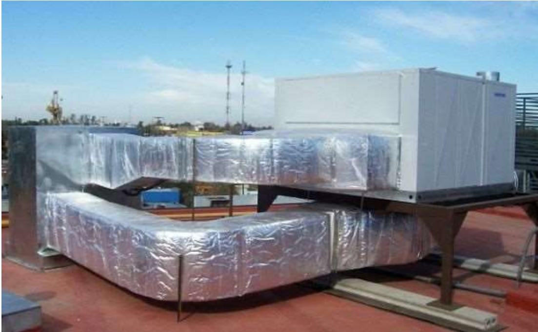
Figura 10. Aire acondicionado central
