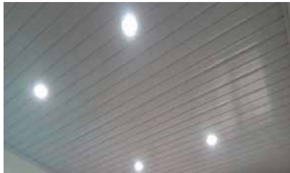
Figura 56. Cielo raso de PVC. http://cielo-raso-uruguay.blogspot.com/2014/06/colocacion-de-cielo-raso-en-pvc-blanco.html (2014)
