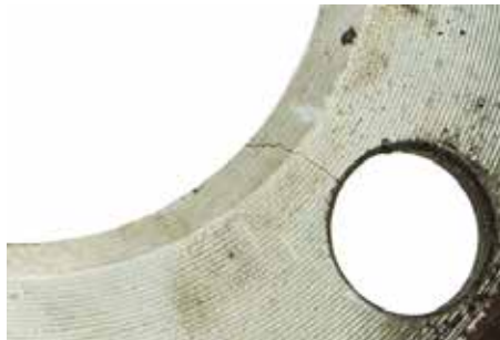
Figura 45. Vista de una fisura en el orificio del disco para el tornillo de la rueda.
