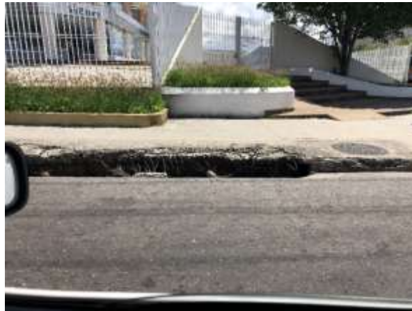
Figura 40: Sumidero de ventana en mal estado.
