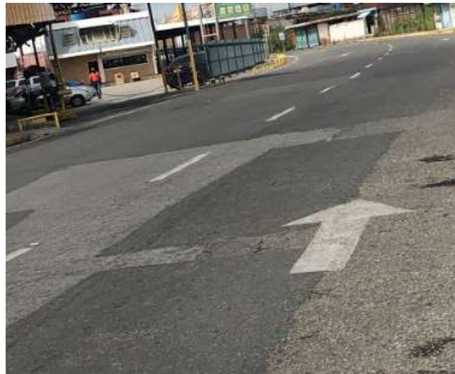
Figura 57: Bacheo o parchado Fuente: Iafaioli y Lugo.
