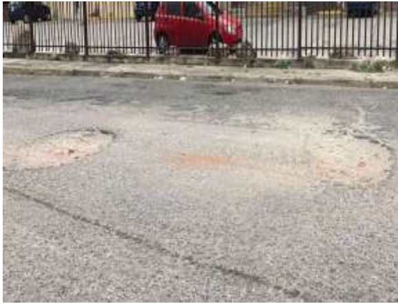
Figura 1: Falla en pavimento
