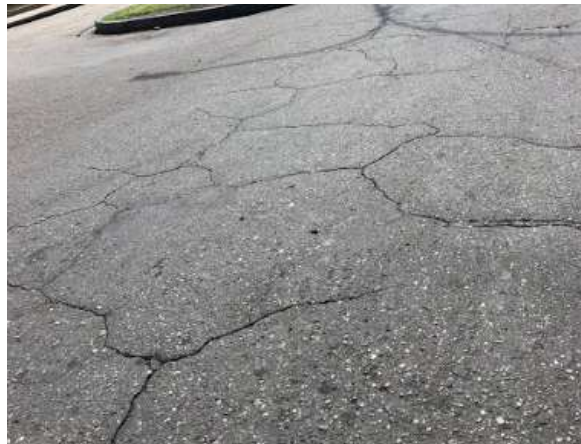
Figura 55: Grietas de contracción.
