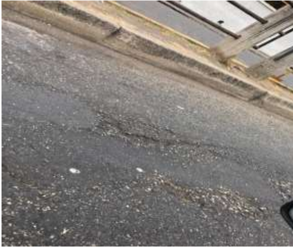
Figura 2: Falla por hundimiento
