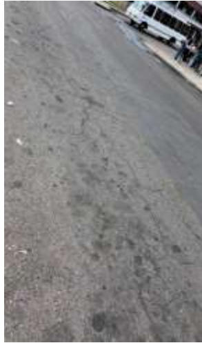
Figura 56: Grietas longitudinales y transversales. Fuente: Iafaioli y Lugo.
