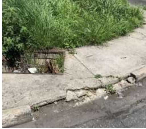
Figura 41: Aceras y sumidero de ventanas en mal estado.
