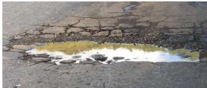
Figura 61: Falla en pavimento Fuente: Iafaioli y Lugo.
