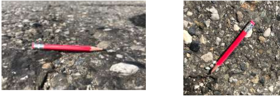
Figura 58: Degradación de la carpeta asfáltica.
