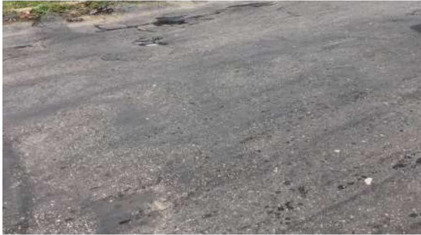
Figura 60: Deformación por empuje Fuente: Iafaioli y Lugo.
