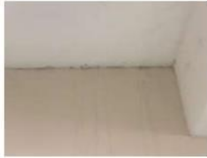
Figura 3: Humedad en paredes Fuente: Vargas (2022)
