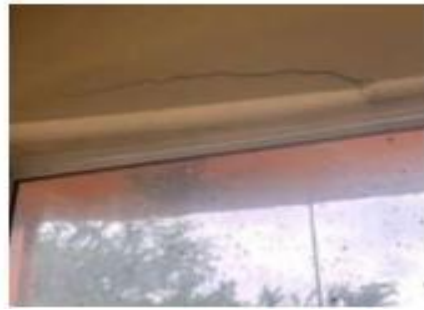
Figura 4: Deterioro en dinteles Fuente: Vargas (2022)
