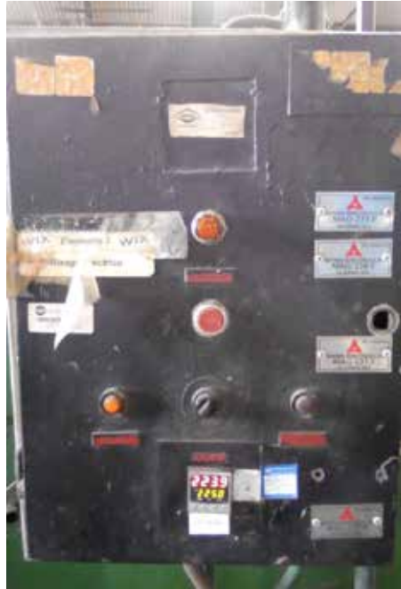
Figura 3. Tablero principal línea de elementos dos
