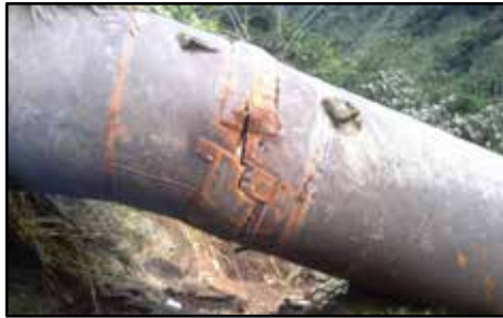
Figura 48: Falla reincidente asociada al deficiente mantenimiento correctivo de una tubería principal de ART.
