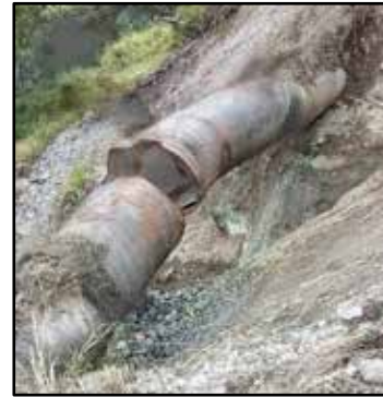
Figura 49: Falla de tubería de conducción de la red de distribución de agua
