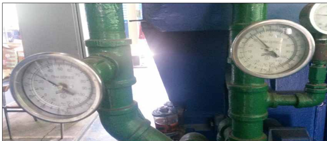
Figura 26. Medidores de temperatura del sistema de enfriamiento por agua de recirculación del compresor Centac– C30.
