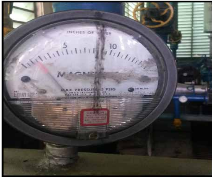
Figura 29. Manómetro ubicado en la tubería de admisión
