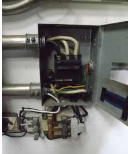
Figura 8. Breaker de encendido de la caseta de radiocomunicación
