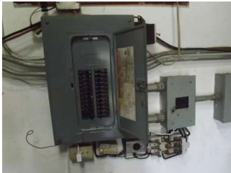
Figura 21. Sistema eléctrico Corpoelec
