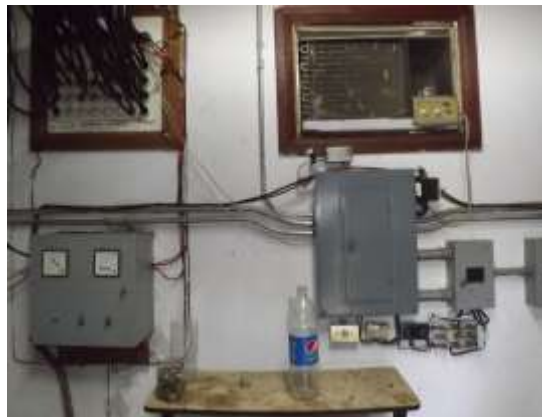
Figura 6. Toma de energía principal, equipos analógicos
