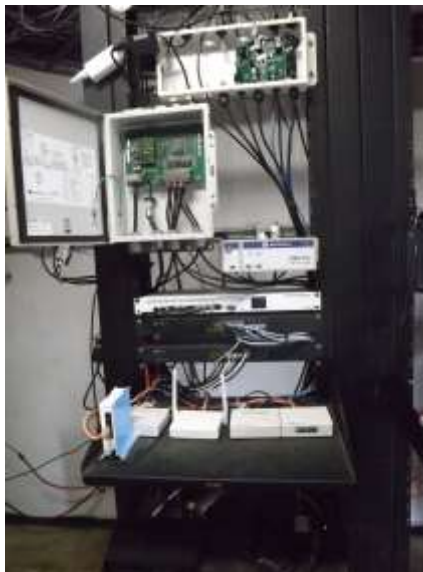
Figura 25. Puesto de trabajo de la conexión de internet hacia la caseta de radiocomunicación
