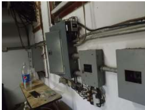
Figura 9. Caja Nema de sistema eléctrico
