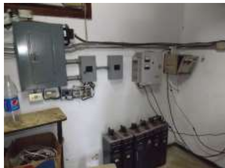
Figura 7. Toma eléctrica de la caseta de radiocomunicación
