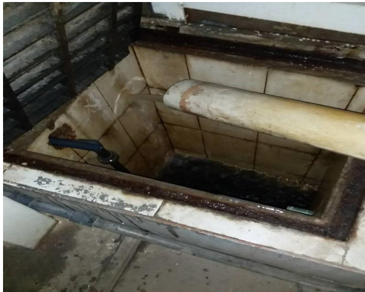
Figura 2 Tanque subterráneo con capacidad de 10.000 litros Fuente: Departamento de Producción Distribuidora Ice Don José, C.A. (2023)
