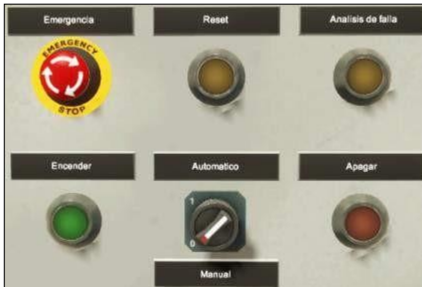
Figura 28. Tablero de control zona de habilitación
