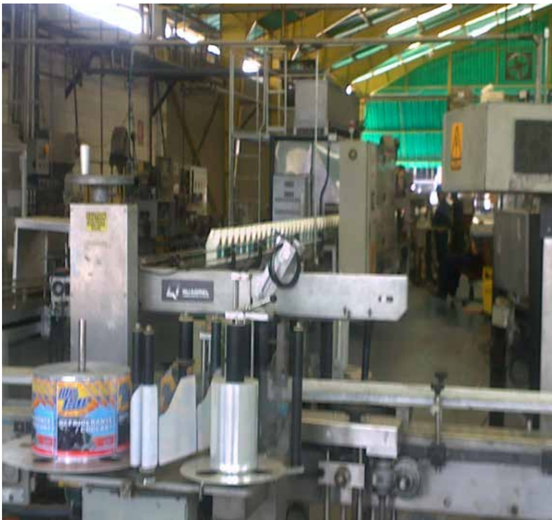
Figura 3 Línea de envasado de aceites lubricantes de la empresa Venezolana de Aceites y Solventes VASSA, S.A.
